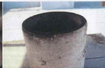
煙突の内側に使用 石綿含有断熱材
